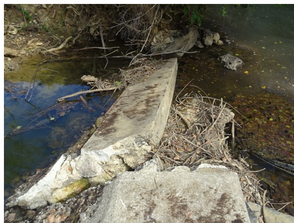
Brèche au niveau du seuil
